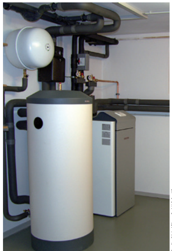
Abb. 2 – Erdgekoppelte Wärmepumpenanlagen erreichen im Vergleich die höchsten Jahresarbeitszahlen.
